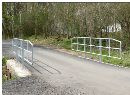
Při rekonstrukci poslední části nového okruhu u hřiště byl zcela opraven i mostek, foto Hana Němečková
